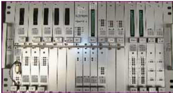
ATP/ATO: complejo sistema de control
